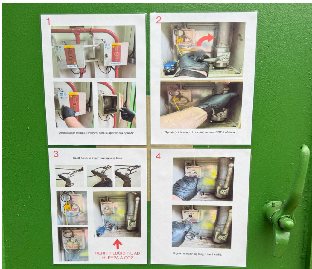
Mynd 5. Notkunarleiðbeiningar sem settar voru upp eftir brunann.
