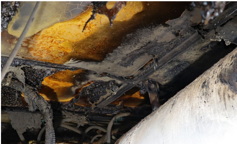
Mynd 2 Loftið fyrir ofan hljóðkútinn, klæðningin brunnin og lekin niður
