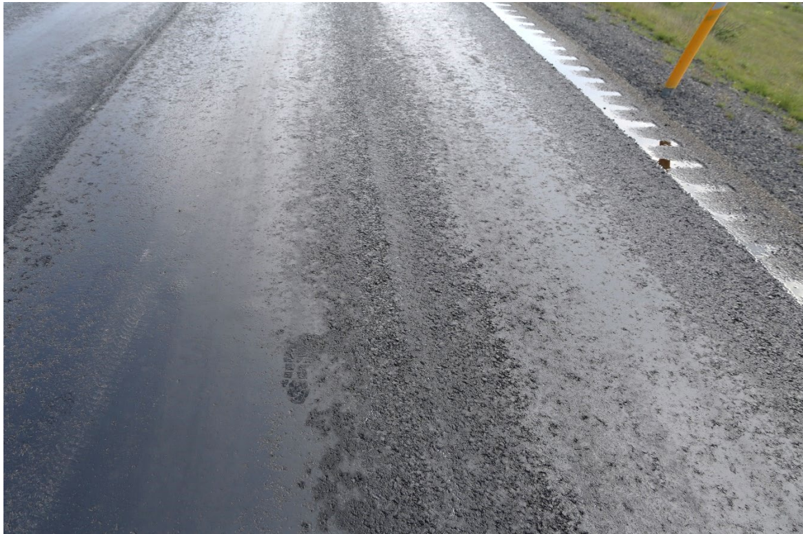
Mynd 3: Vegyfirborð rétt eftir slysið. Bindiefnið í malbikinu hafði komið upp á yfirborðið við völtun og þunga frá umferð, við það mynduðust stórir samfelldir feitir blettir á veginum sem urðu afar hálir eftir rigningu.
