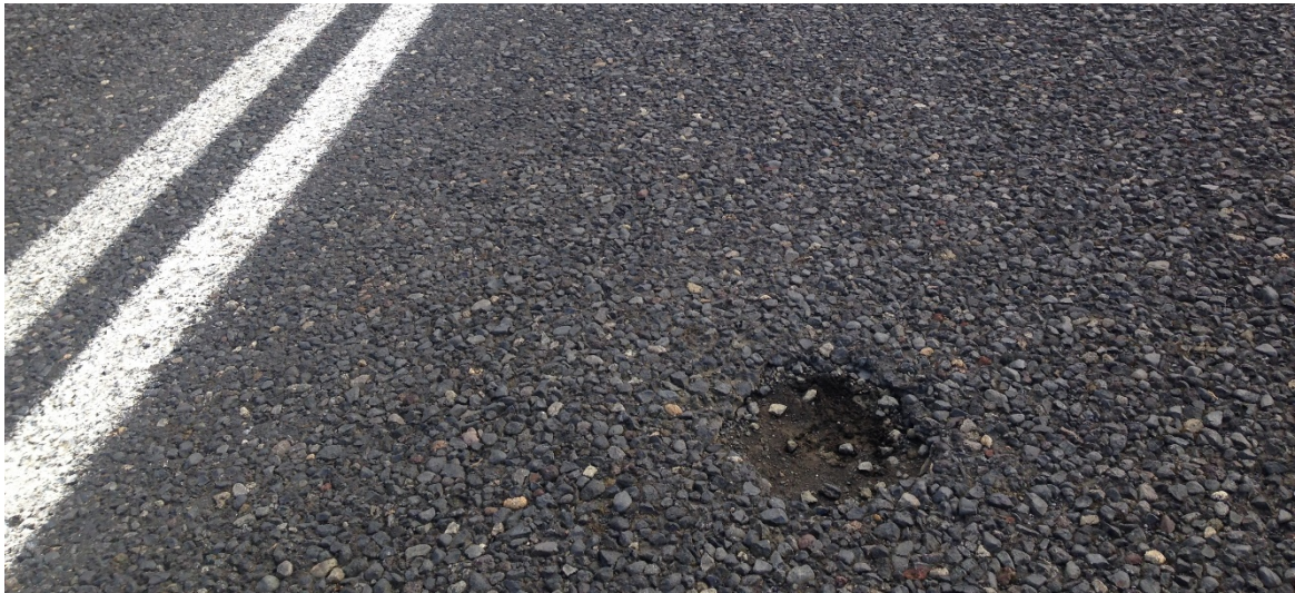
Mynd 5: Á veginum voru nokkrar holur sem náðu í gegn um slitlagið.
