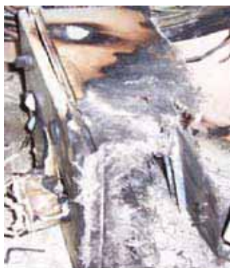
Hleðslustöð brunnið að ofan
