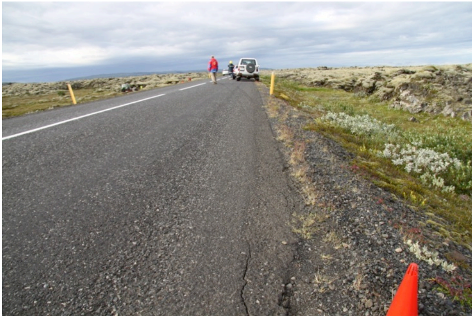
Horft austur Suðurlandsveg. Sjá mátti för í hægri vegkanti þar sem keilan er og sveigför til vinstri á veginum.
