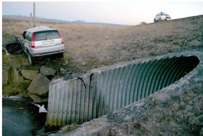
Mynd 2. Vegræsið er felld inn í fláa vegarins. Þessi óvarða geil í umhverfi vegarins er hættuleg fyrir ökumenn.
